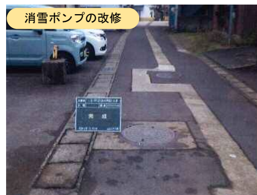
⑬ 市道第 1131 号線消雪施設
