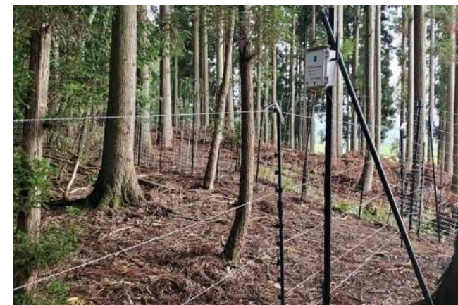
▲電気柵電圧監視システム
