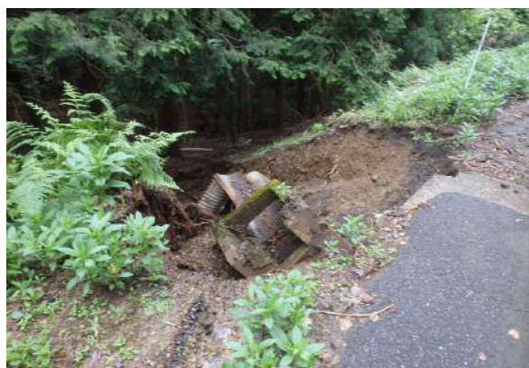
(被災した林道沿いの集水樹の様子)
