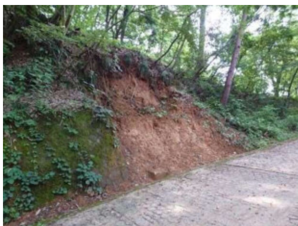
▲被災箇所②
